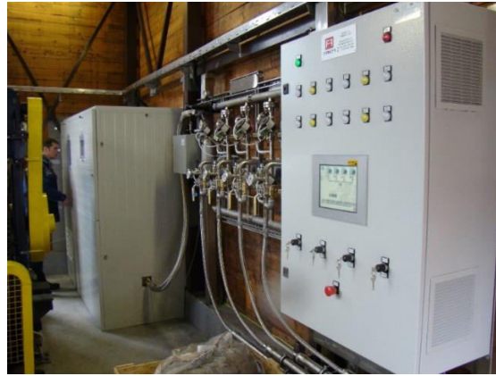
Slika 5: Kompresorska postaja, upravljalna plošča za zrak in upravljalna omara zapornic [1].
